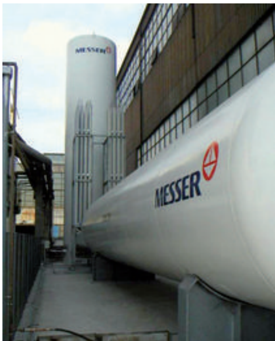
Abb. 9: Speicherbehälter für flüssigen Stickstoff (stehend) und gasförmigen Wasserstoff (liegend)
