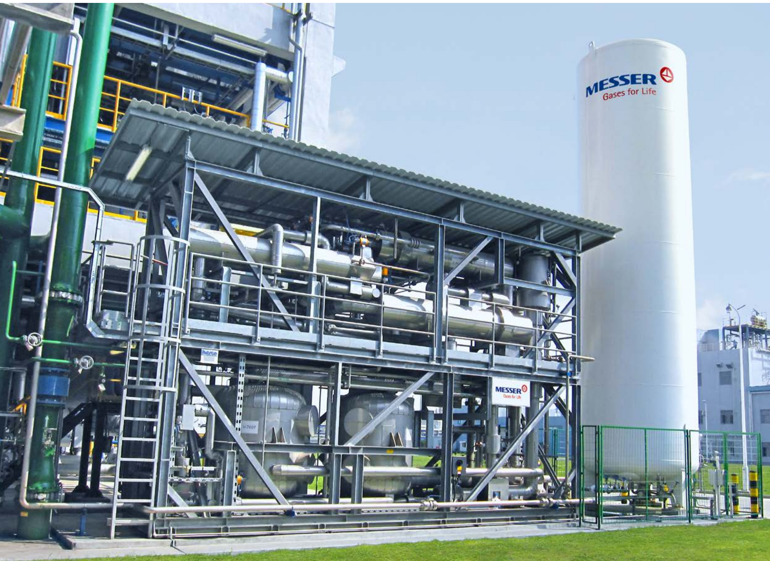
Rückgewinnungsanlage für Methylchlorid
